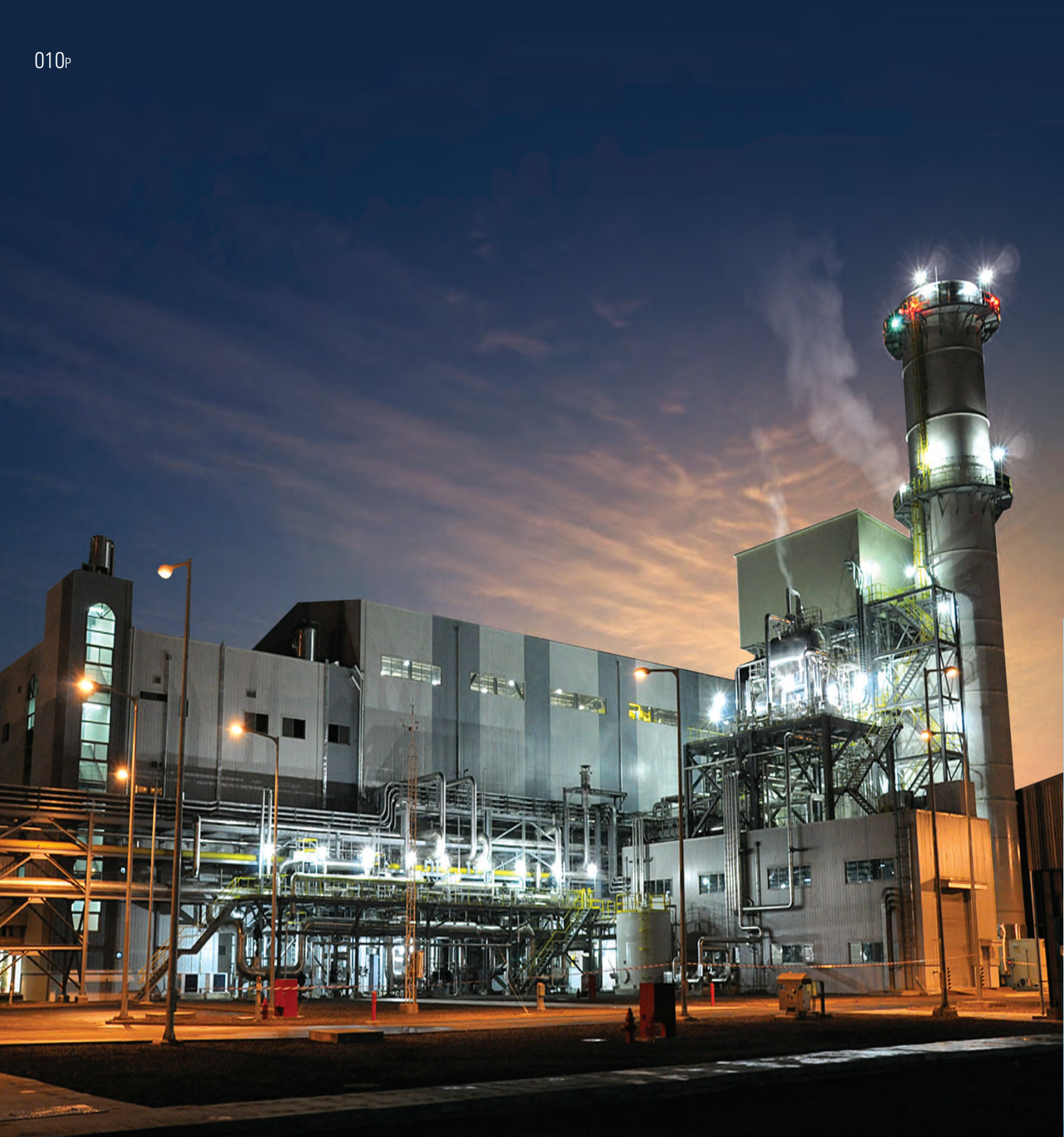
010P Yerevan 복합화력발전소 위치: Yerevan, Armenia - 복합화력발전: 230MW - 가스터빈(167MW×1) - 스팀터빈(63MW×1) 공사기간: 2007. 12 ~ 2010. 04
